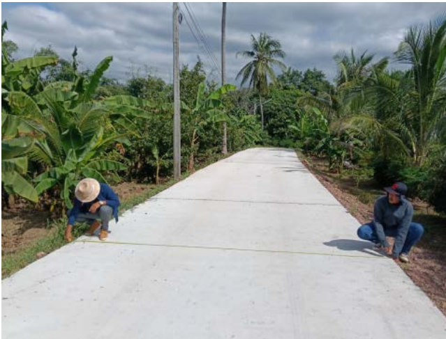
ก่อสร้างถนนคอนกรีตเสริมเหล็กจากหัวสะพาน-บ้านนายเสรี หมู่ที่ ๒
